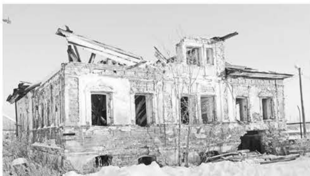
Сейчас дом Бакулева находится в полуразрушенном состоянии.
